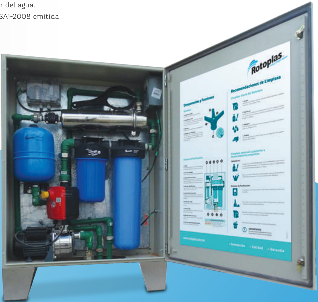
Sistema de Ultrafiltración
